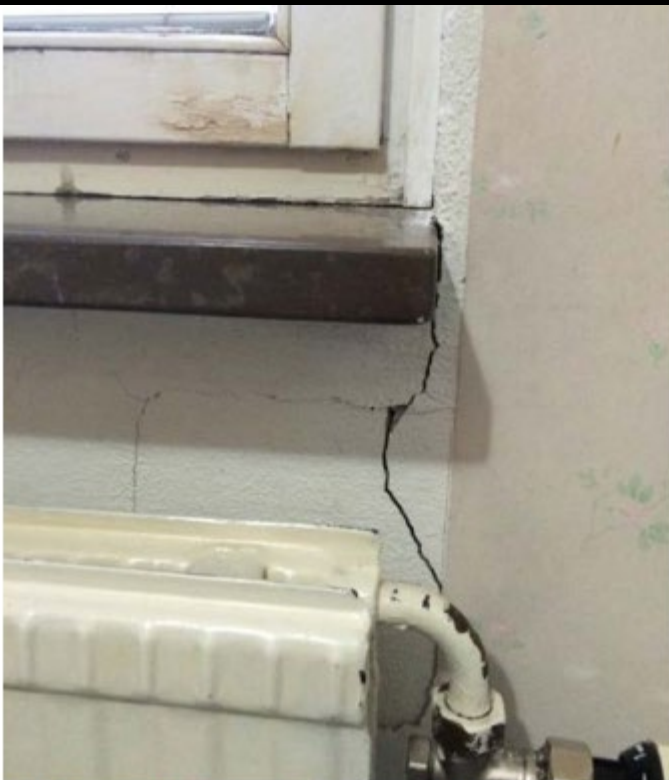
Bild 2. Spricka i vägg i sovrum i lgh 1602.
