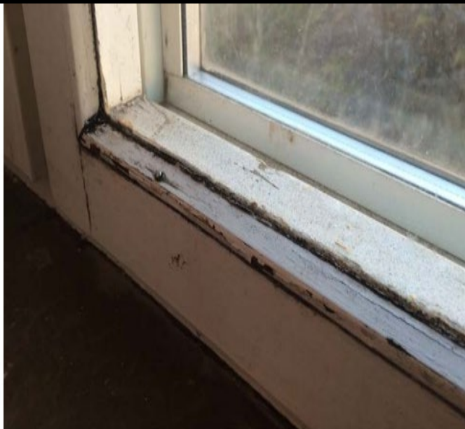
Bild 1. Fönsterkarm i sovrum i lgh 1601.
