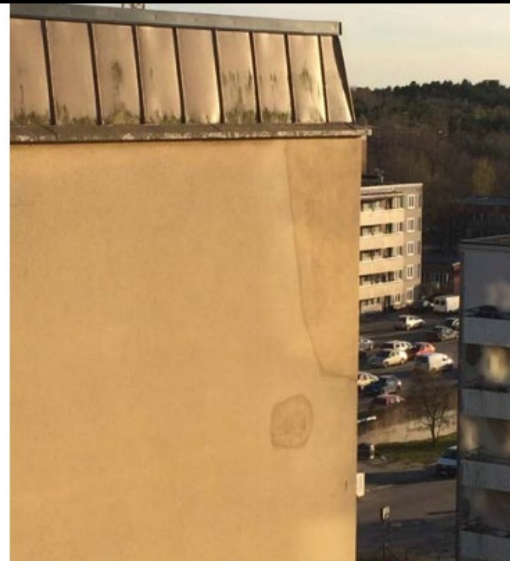
Bild 6. Fuktskadad yttervägg på fasad Fjärdholmsgränd 19.
